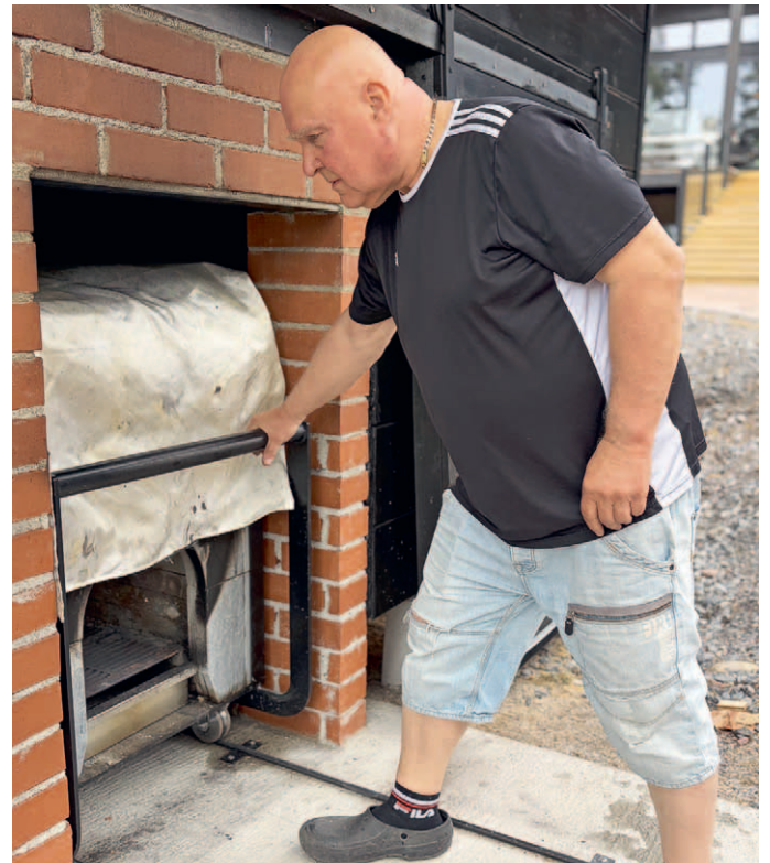
Kiuas kivinen painaa noin 1 500 kiloa, mutta kiskojen avulla kiukaan voi vetää kevyesti sisään ja ulos.
